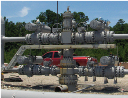
Ces vannes FlexStream sont installées dans une unité de stockage de gaz (caverne de sel) Ces vannes ont la capacité unique de réguler la baisse de pression en phases de remplissage comme de soutirage.
